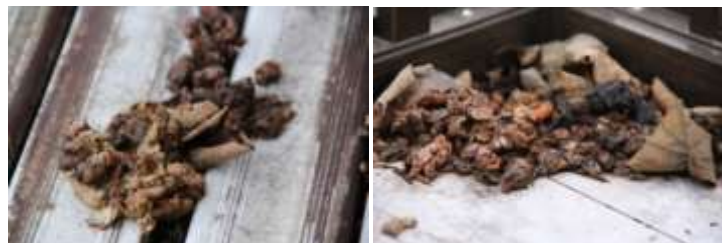
図 2 屋上ベランダ隅の溜糞
