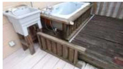
図 6(2)屋上露天風呂 給水部(蓋開)
